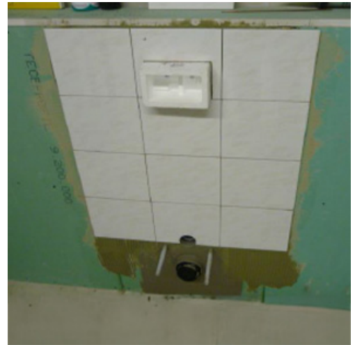
6B. TOINEN VAIHE Jatka laatoitusta.
